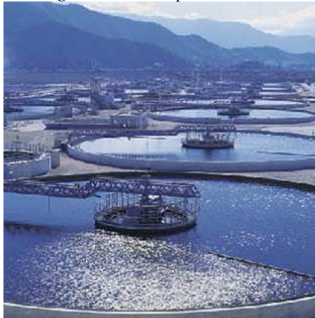
Figura No. 8. Estanque de oxidación
