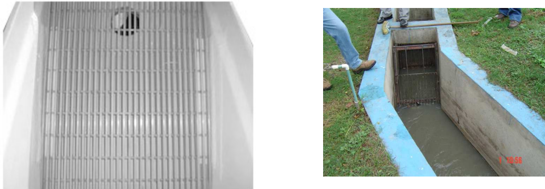
Figura No. 6. Ejemplos de pre tratamientos (rejillas de desbaste)
